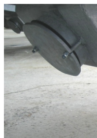
Stenfælde for beskyttelse af pumpen
